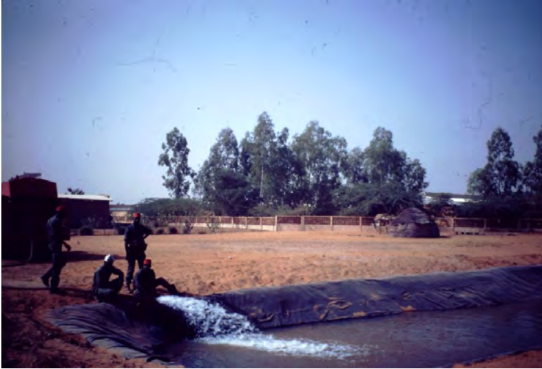
Figure 4 : Mare artificielle créée avec l'aide des pompiers Figure 4: Artificial pond created with the help of the fire department
